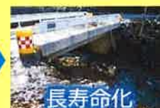
橋梁の老朽化
